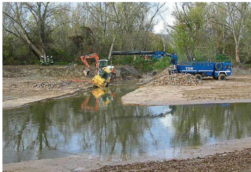
Feuerwehr und Technisches Hilfswerk verhindern am Sonntag, dass Baufahrzeuge an der Schönbornschen Aue vor Geisenheim in den Rhein kippen. Foto: Georg Mahr
